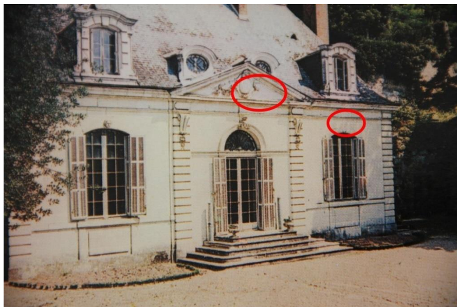
Figure 155. La façade est endommagée par les années de non entretien
