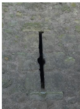
Figure 70. Présence d'étranges meurtrières
