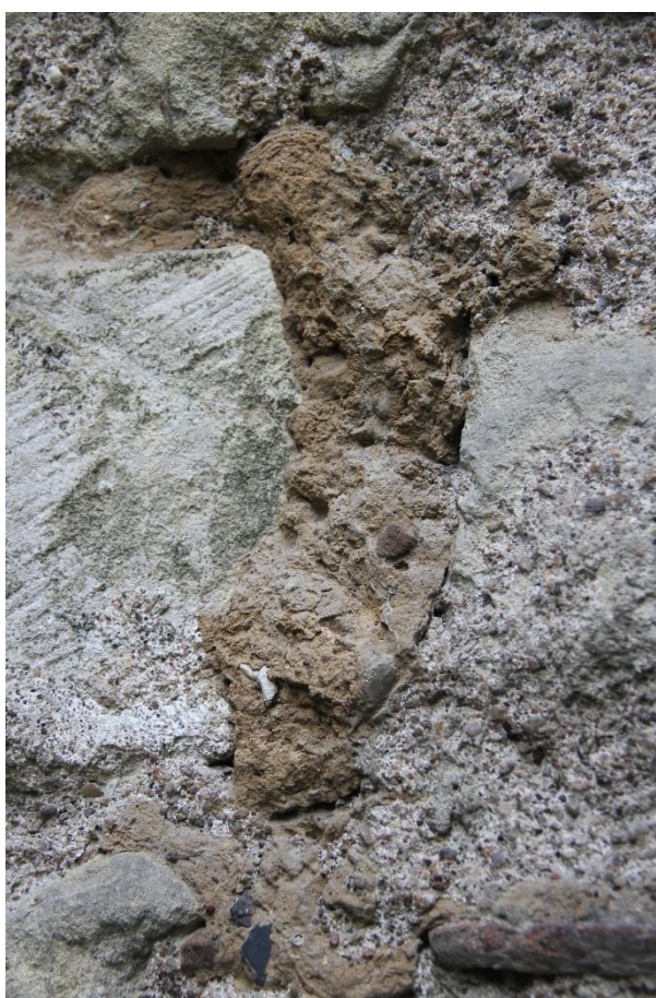
Figure 36. On peut constater la présence de joints en argile, certaines fractions ont été recouvertes de ciment : réalisation probablement tardive avec une motivation de protection
